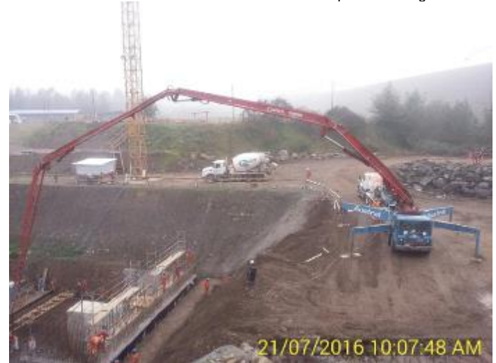
Hormigonadura del Radier de la 3ª Etapa de Hormigonado de la Casa de Máquinas.
